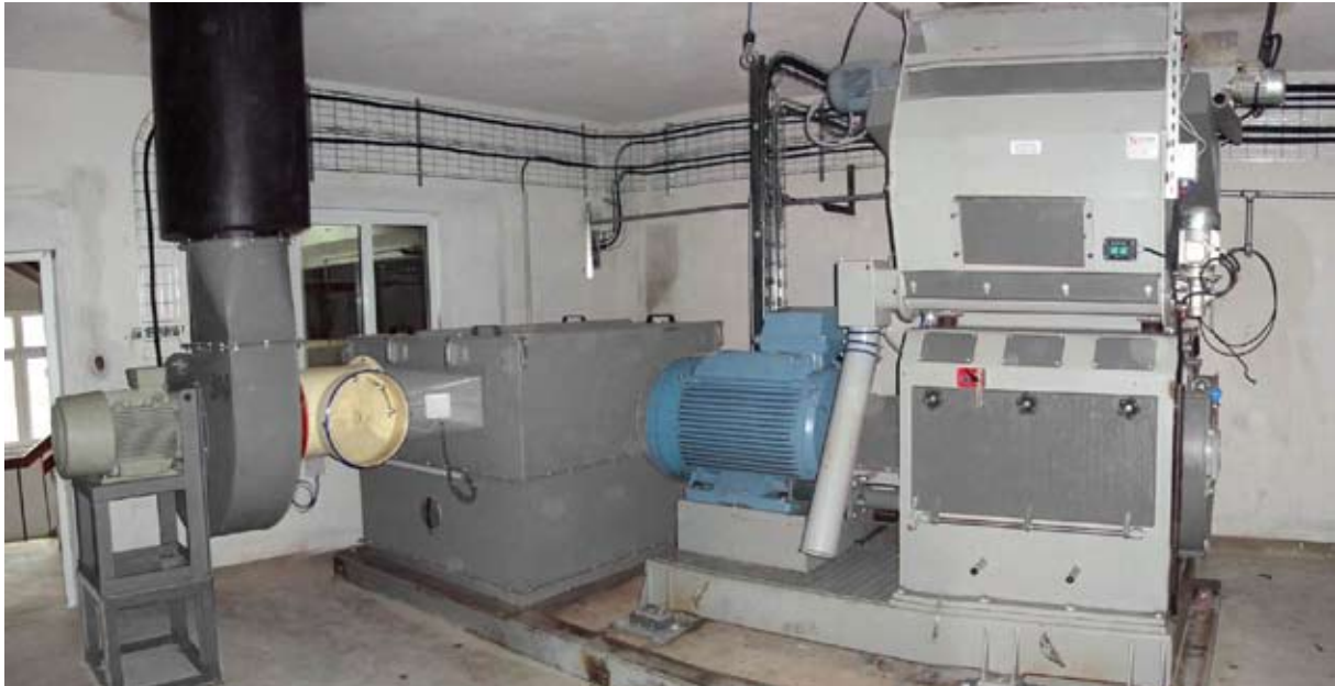
Installation de broyage à reprise mécanique
