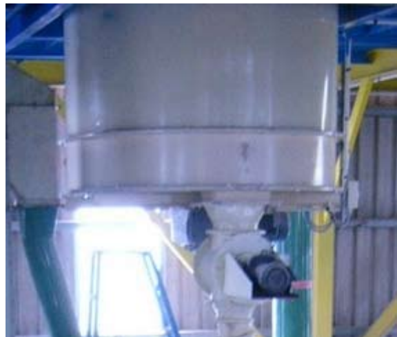
Filtre avec bras ramasseur
