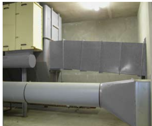
Event d'explosion et conduit de mise à l'air libre
