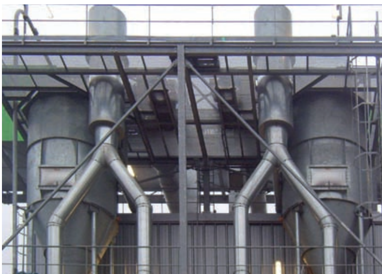
Filtres à manches avec vannes de découplage et membrane d'explosion
