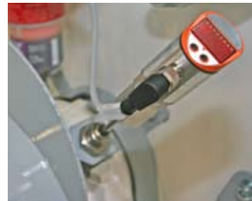
Sonde de contrôle des température sur paliers
