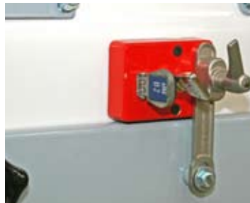
Interverrouillage des portes par transfert de clés
